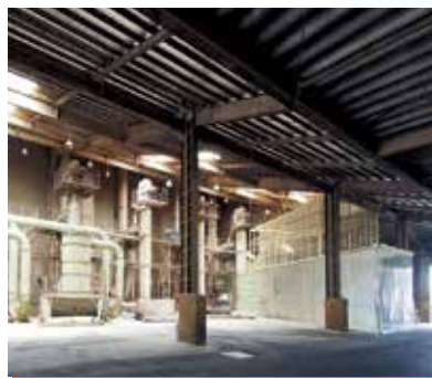
動蛋原料搬入設備
