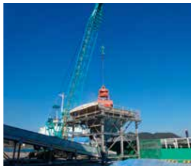
グラブバケット設備
